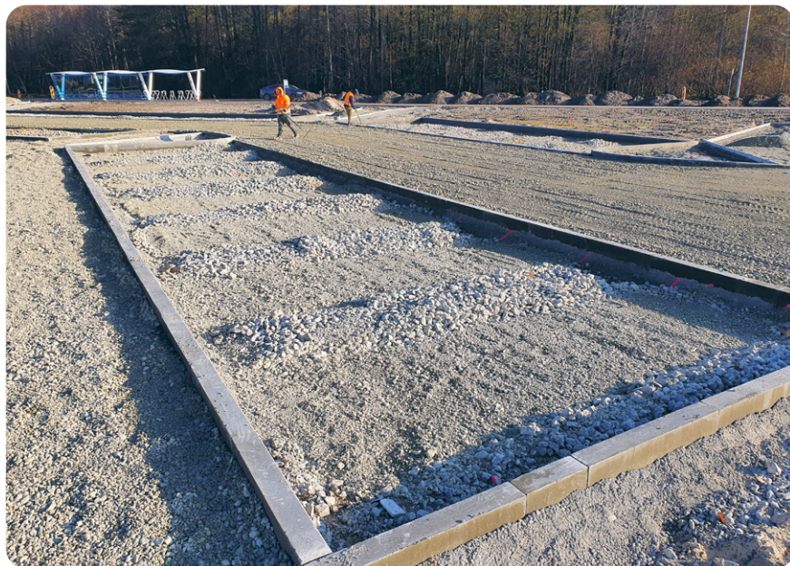
Foto 28. Vett läbilaskva drenibetooni ja murukivi kombinatsiooniga lahenduse aluse ettevalmistustööd Viimsis. Küllustikuga tõstetud kohtadele paigaldatakse betooni rakis. Foto: Alar Mik
