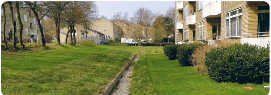
Foto 30. Täidisdreen kortermaja vundamenti kaitseks sõiduteelt valguga sademevee eest Taanis Kopenhaagenis. Foto: Gen Mandre
