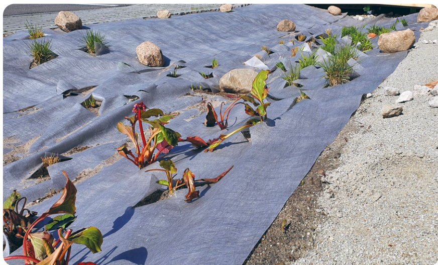
Foto 40. Vihmapeenra rajamine Viimsis Haabneeme kooli parklas. Paigaldatud geotekstiili all asub kasvupinnas, kanga peale tuleb killustiku kiht. Foto: Alar Mik
